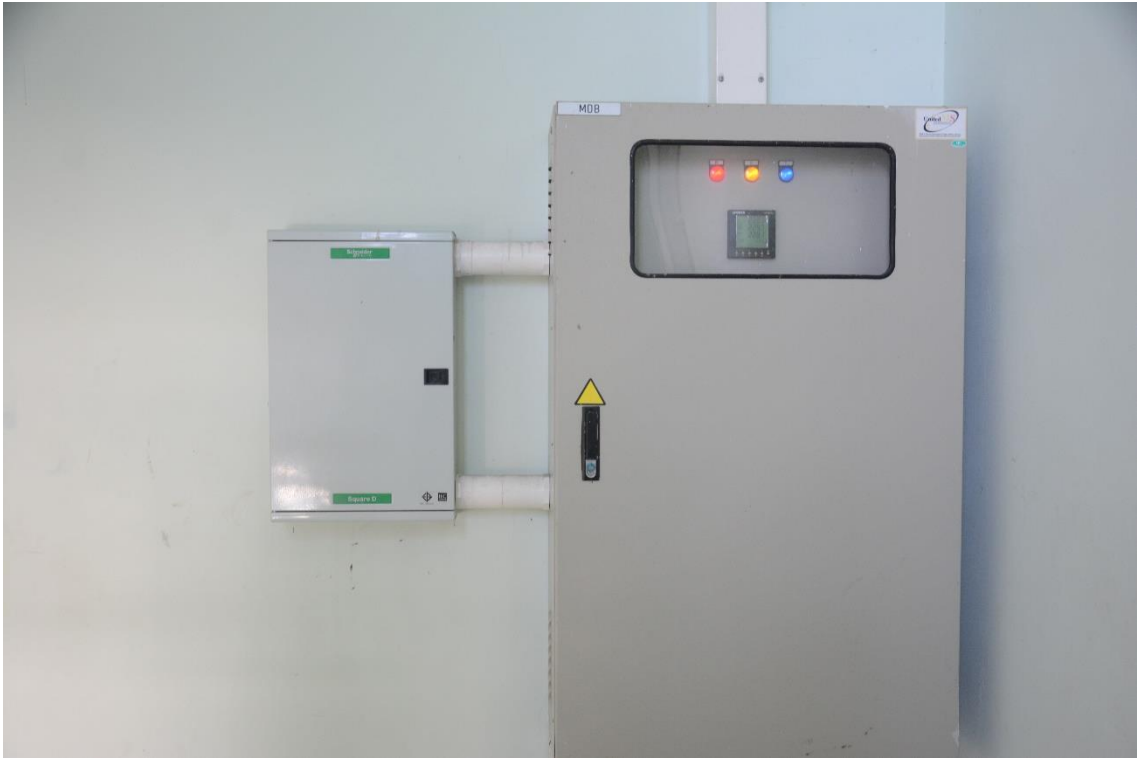
ภาพที่ ๑ ตู้ควบคุมระบบไฟฟ้า
