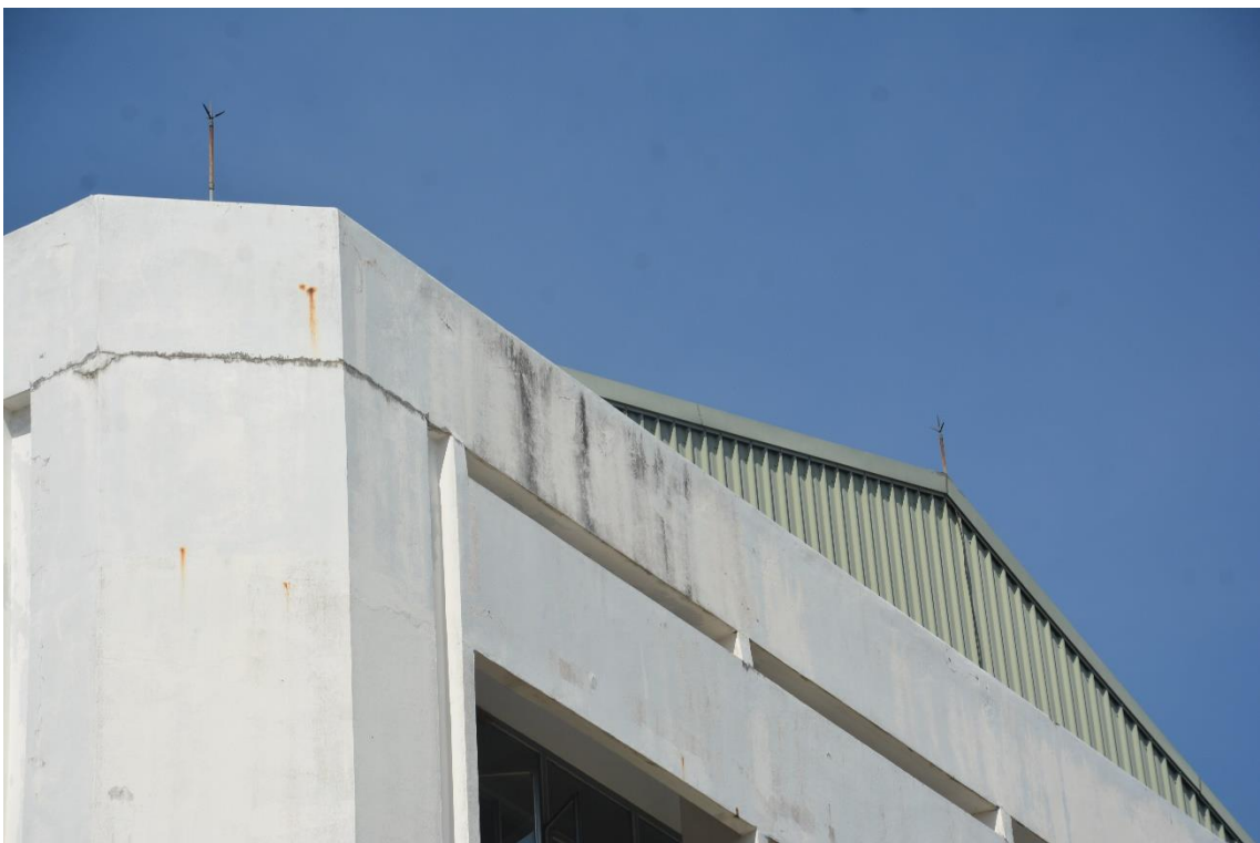
ภาพที่ ๔ สายล่อฟ้าบนดาดฟ้าของอาคารเรียน
